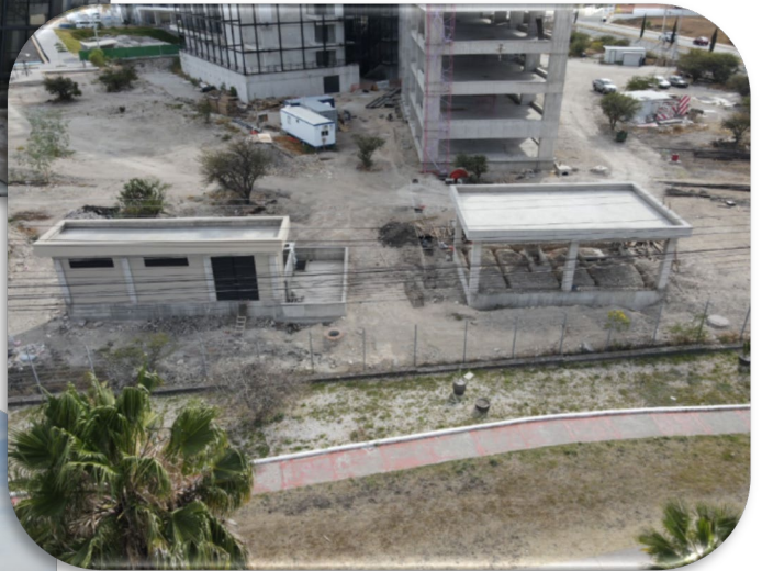
Foto 40. Cuarto de máquinas para la subestación
