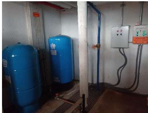
Cambio de hidroneumáticos y tableros de mando
