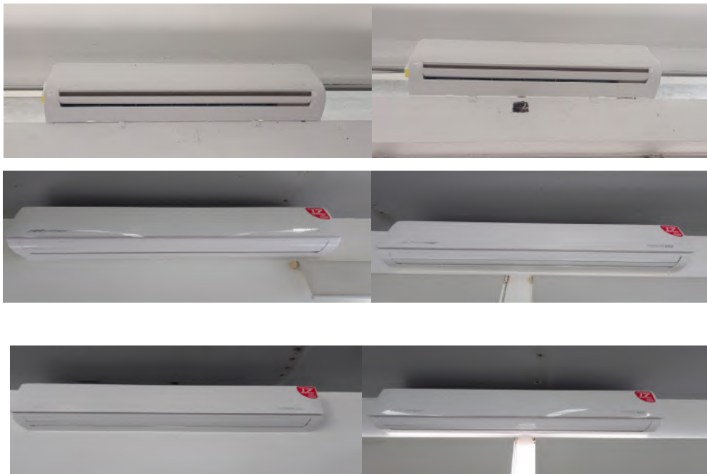
Seis aires acondicionados habitaciónshabitaciones 107, 108 y aula, Aula 1 y aulaAula 2
