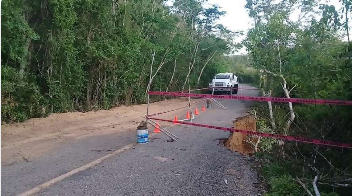
Derrumbe del camino de entrada a la Estacion Chamela
