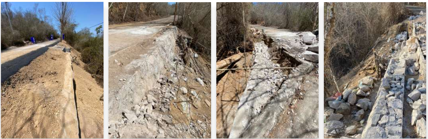
Muros de contencion construidos por la SCT sobre el camino de entrada a la Estacion Chamela
