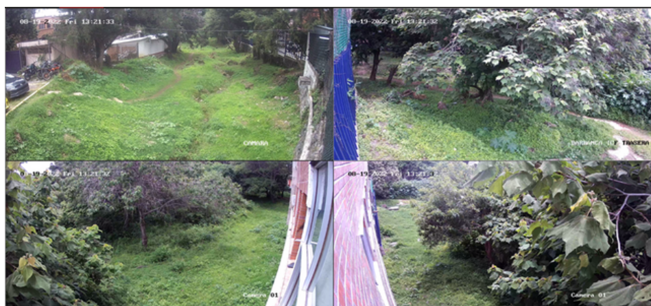
Sistema CCTV en la Biblioteca y exterior del ICF
