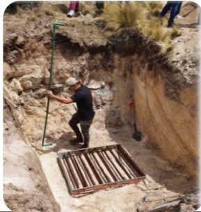
Intercambiador de Calor con el Subsuelo
