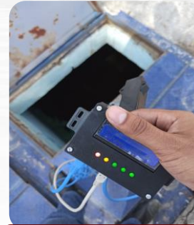
Equipo de telemetría
