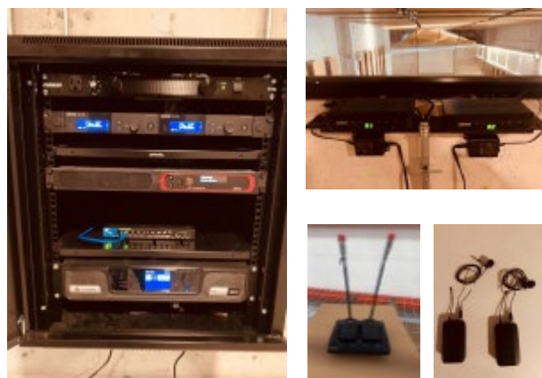
Foto 90. Equipo de audio instalado en el foro de la ENES Juriquilla
