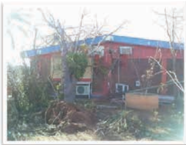
2. AC caídos y árboles inclinados sobre edificios
