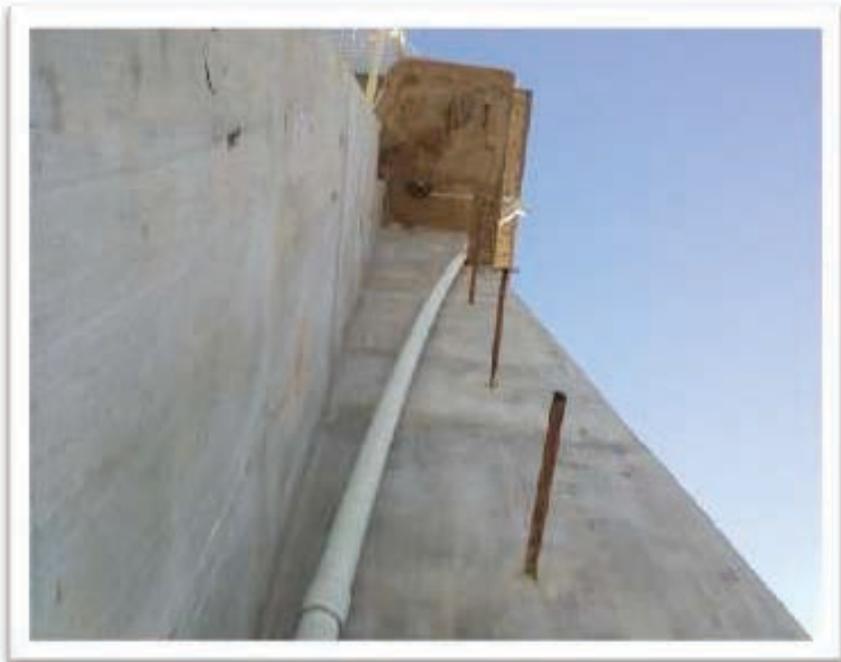
4. Tubería de agua de tanque elevado dañada
