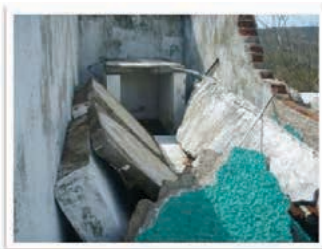
4. Base y pared destruídas, tres tinacos de 1,000 litros en el suelo
