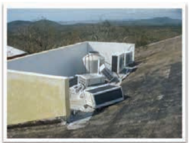
3. Aires acondicionados arriba de edificio de usos múltiples
