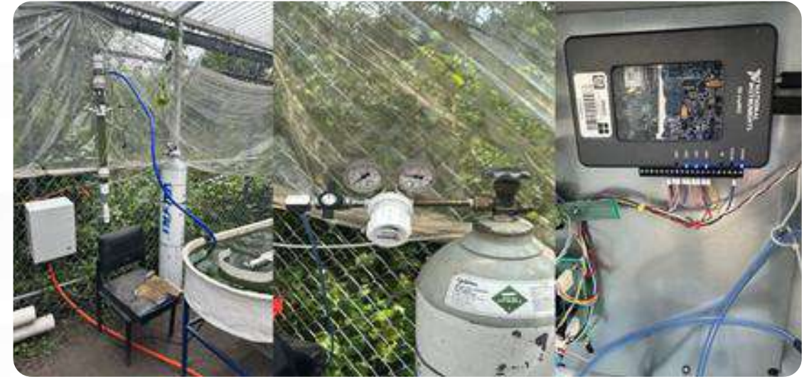
Instalación e instrumentación de un sistema de CO2.
