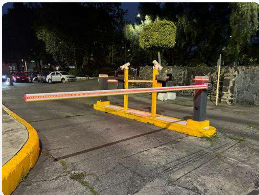
Cambio de Sistema de Control de acceso al estacionamiento
