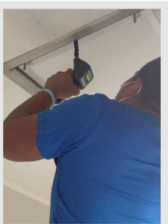
Pruebas de integridad a filtros HEPA
