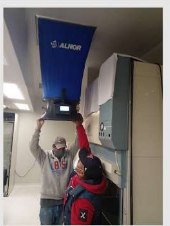
Balanceo de áreas y calificación del sistema HVAC
