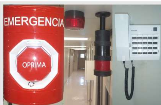
Alarmas audibles y visibles para emergencias Sistema de intercomunicación
