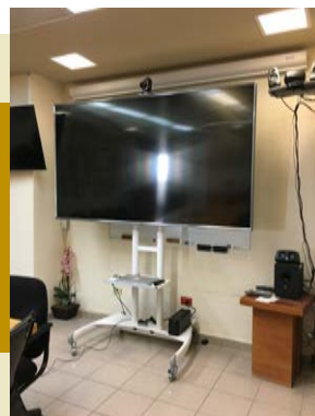
Figura 30. Equipo de videoconferencia instalado en la sala de Consejo Interno de Dirección.
